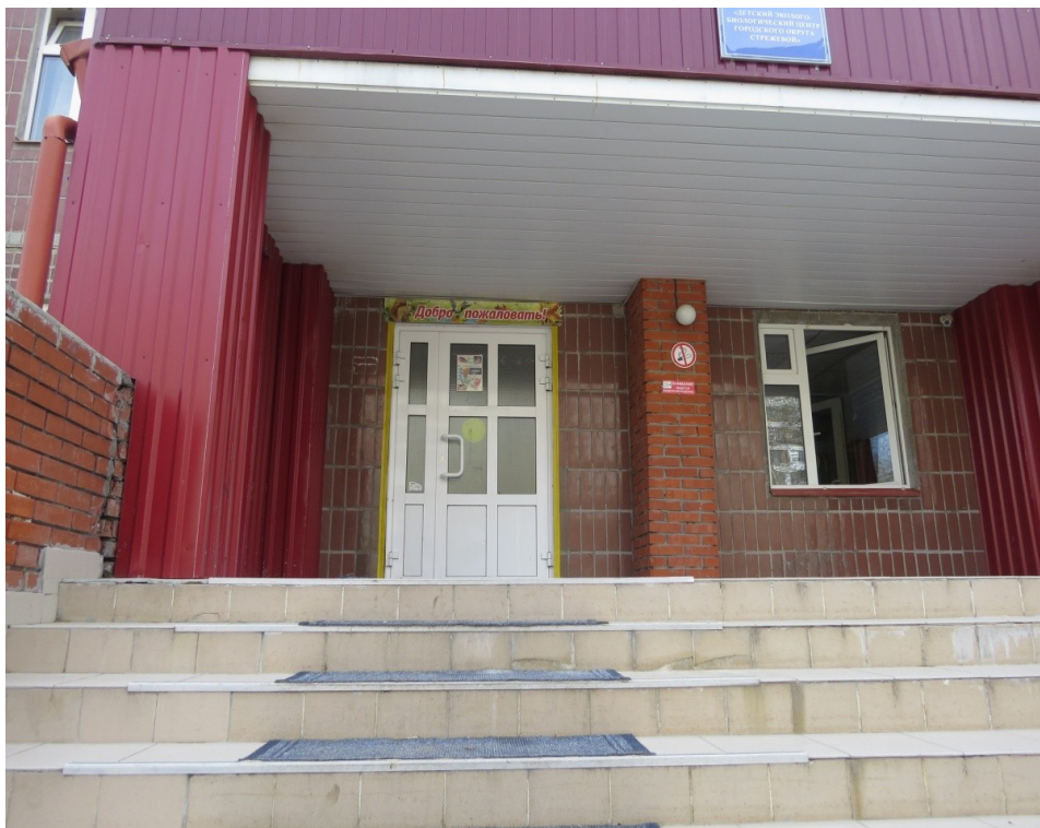
Фото 7 – Входная дверь с площадкой №1. Отсутствуют фиксаторы положений «открыто» и «закрыто», имеется контрастная маркировка
