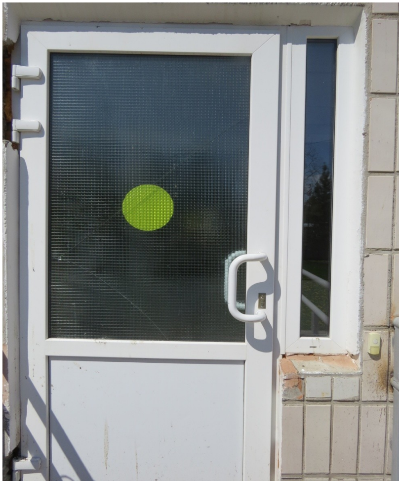
Фото 15 – Входная дверь с площадкой № 2 и кнопкой вызова сотрудника. Отсутствуют фиксаторы положений «открыто» и «закрыто».
